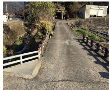
粟原地区道路 河川増水により道路浸水。 通行不可
